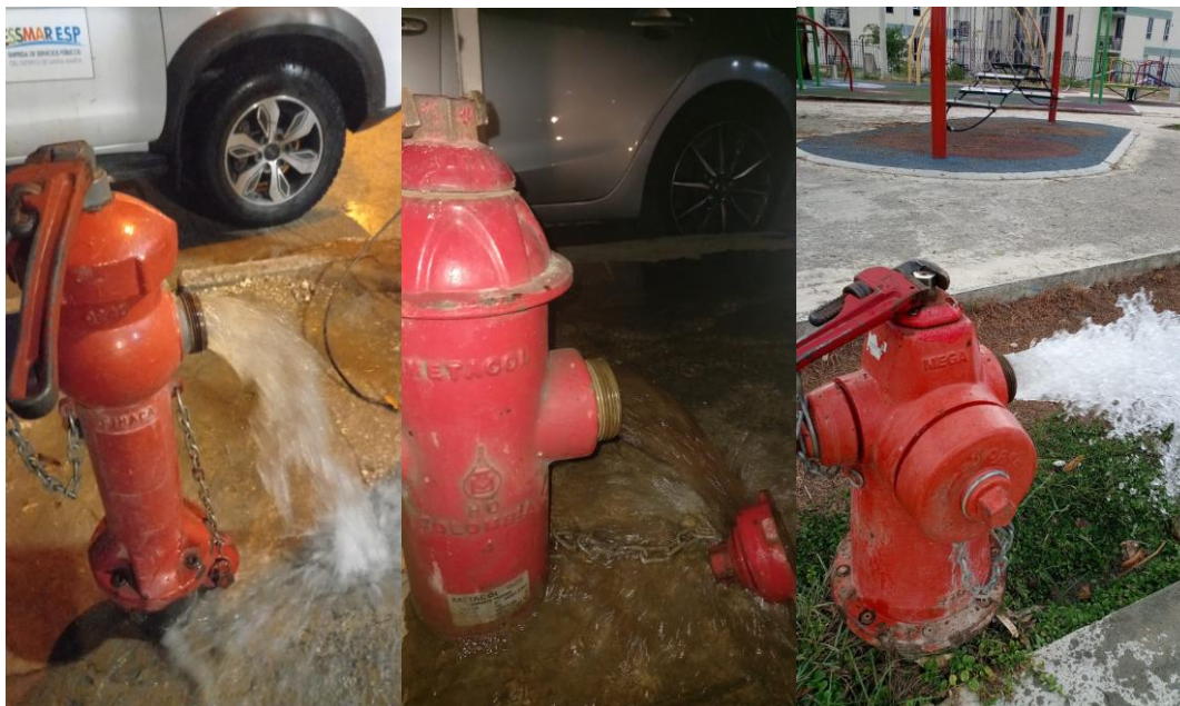
Purgas en Hidrantes y Puntos de muestreo Fuente: Dirección de Acueducto
