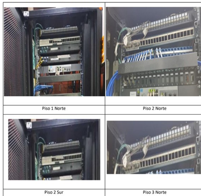
2.7.1. Bandejas de fibra Edificio nuevo del Congreso.
